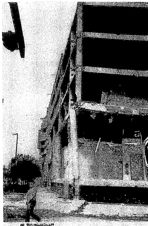
写真7.1985年メキシコ地震により倒壊寸前に至った7階建1スパン建物。柱梁接合部の顕著な被害に対し、柱や梁の損傷は殆んどみられない。
