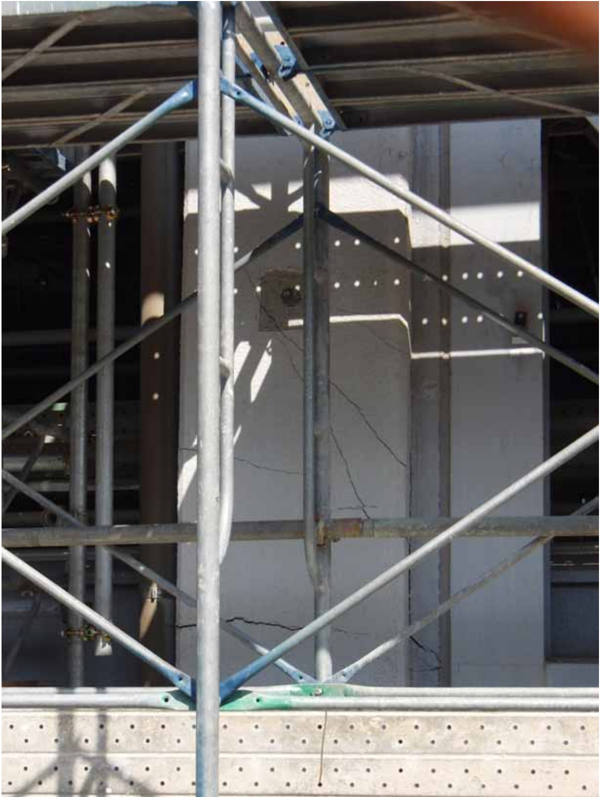
柱の最終状況 (2) ブレース構面の加力点側柱のせん断破壊
