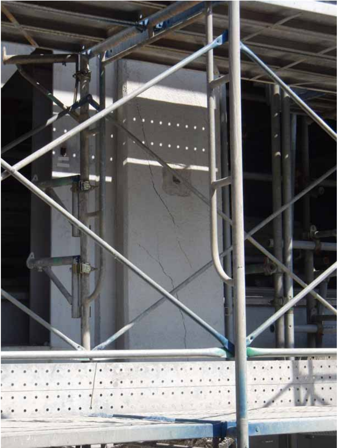
柱の最終状況 (3) ブレース構面の加力点と反対側柱のせん断破壊
