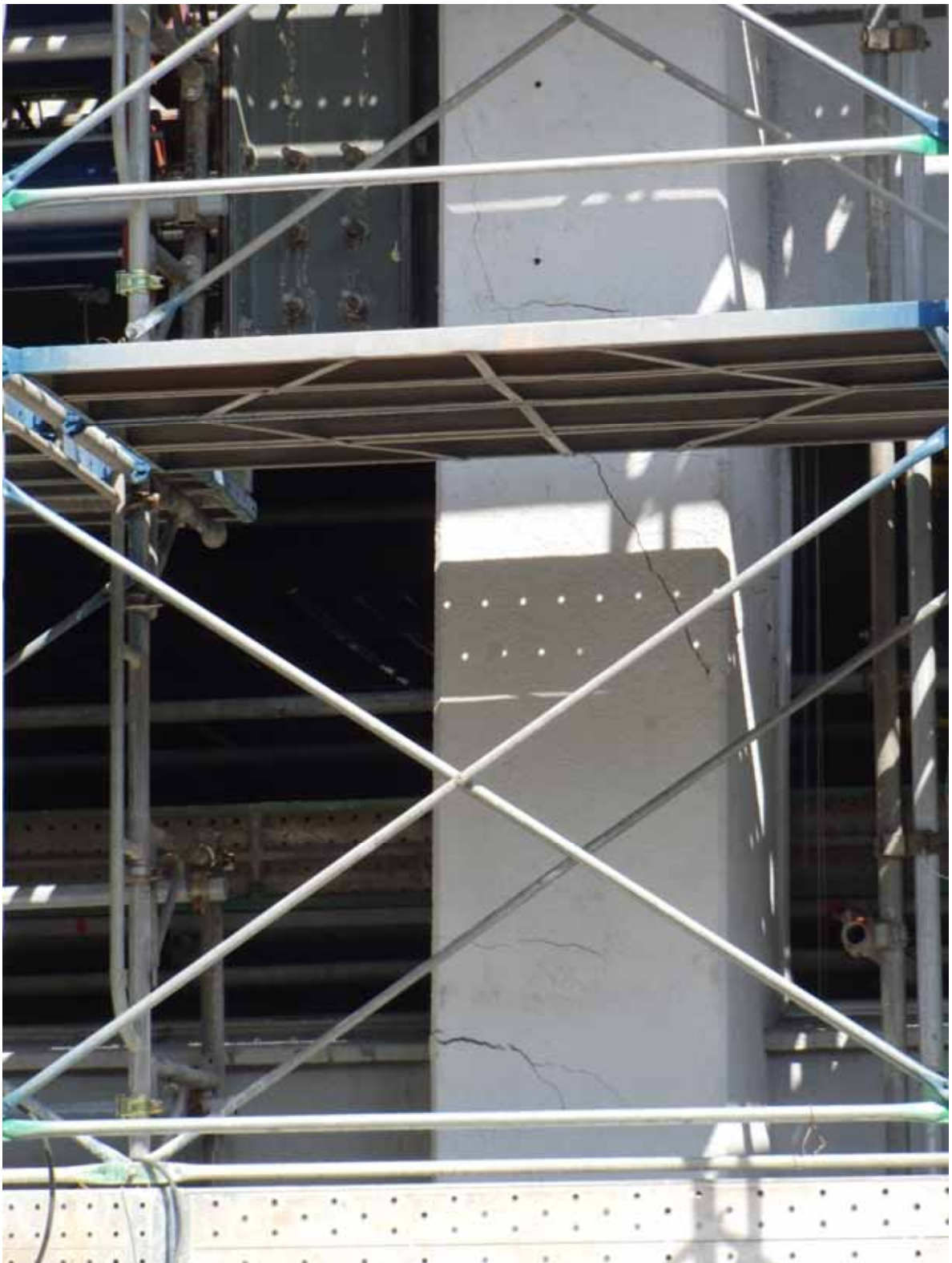
柱の最終状況 (1) 加力点側のブレースがついていない柱のせん断破壊
