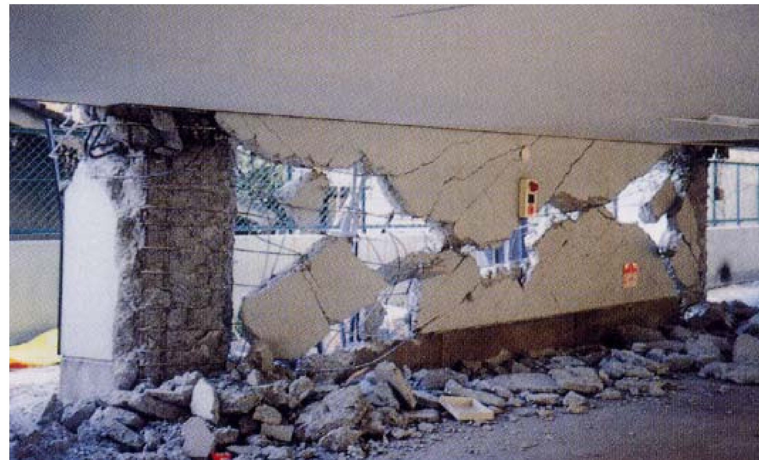
阪神・淡路大震災での耐震壁の被害
