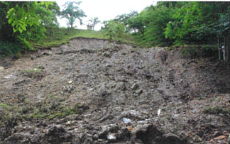
楯山公園北側斜面の被災状況
