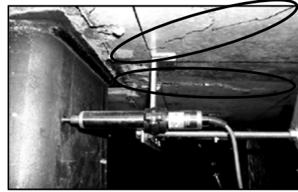
写真 3. 2. 2. 3 Fp4 柱前後面近傍ひび割れ状況
